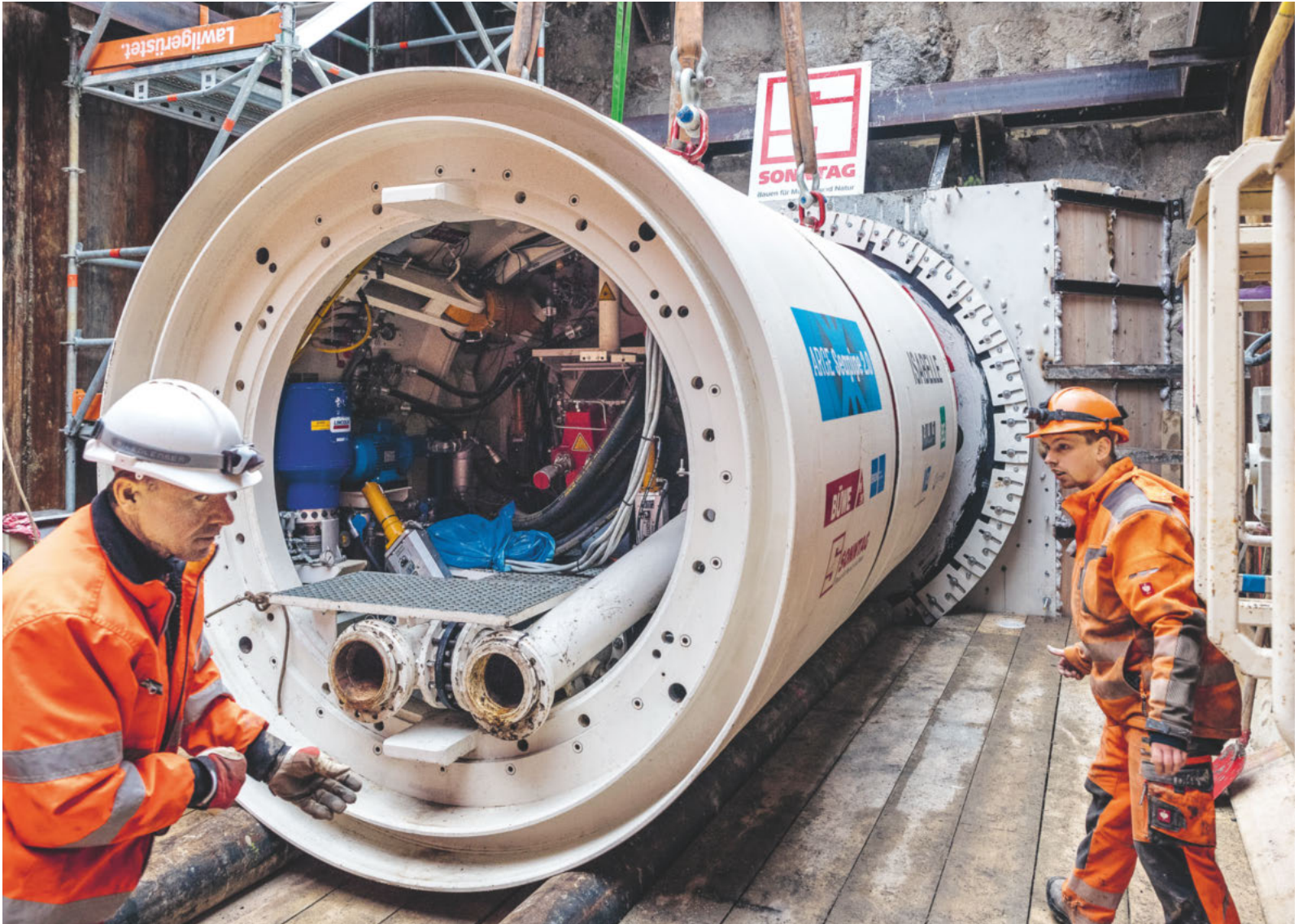
Das mehrere Kilometer lange unterirdische Verteilnetz für den Seewasser-Energieverbund Circulago wird im Microtunnelingverfahren gebaut.
